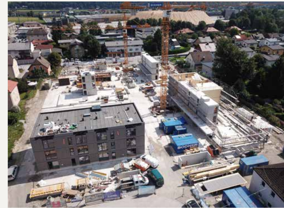
Das Wohnprojekt „Burgfried“ in Salzburg: Dank der neuen Winkelösung des Herstellers Pitzl können die Bewohner einziehen und ihre Ruhe in den eigenen vier Wänden genießen.
